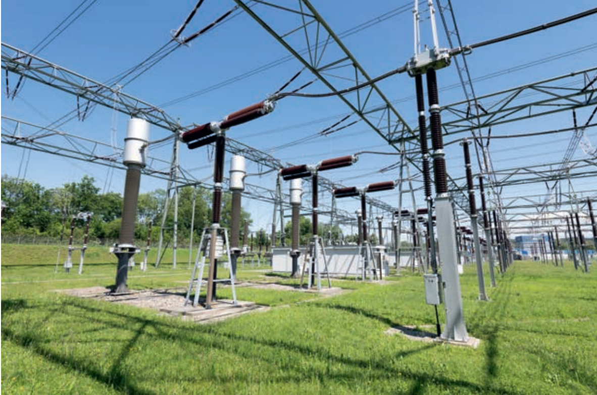
Unterwerk Gösigen der Swissgrid AG 380-kV-Hochspannungs- Schaltanlage
