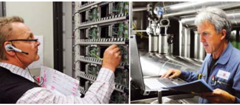
Jahresrevision 2010 Prüf- und Einstellarbeiten an elektrotechnischen Einrichtungen
