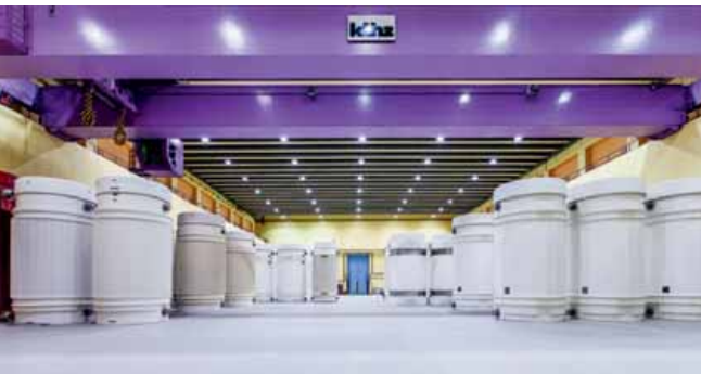
Zwiilag Blick in die Behälterlagerhalle
