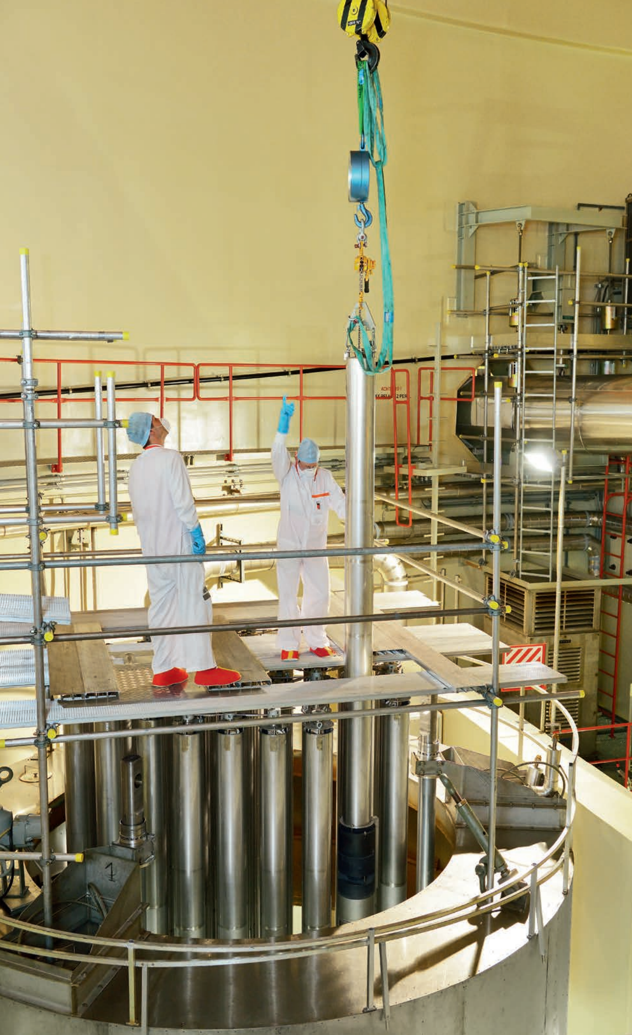
Inspektion von Steuerstabantrieben Eine Antriebsspuleneinheit wird angehoben.
