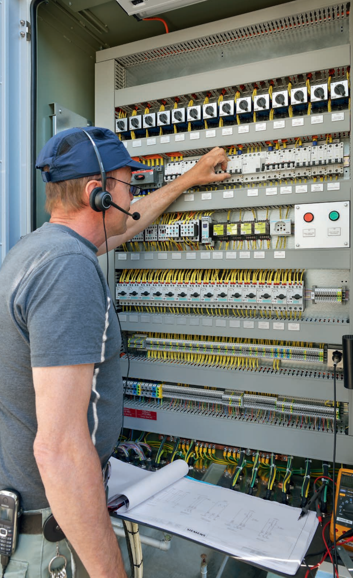
Am Steuerschrank des Fremdnetztransformators Kontrolle von Signalen und Steuerbefehlen
