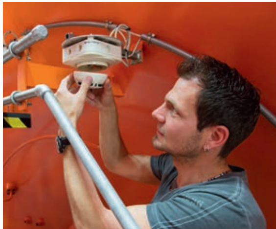
Am Generator Sichtkontrolle der Brandmelderbefestigungen
