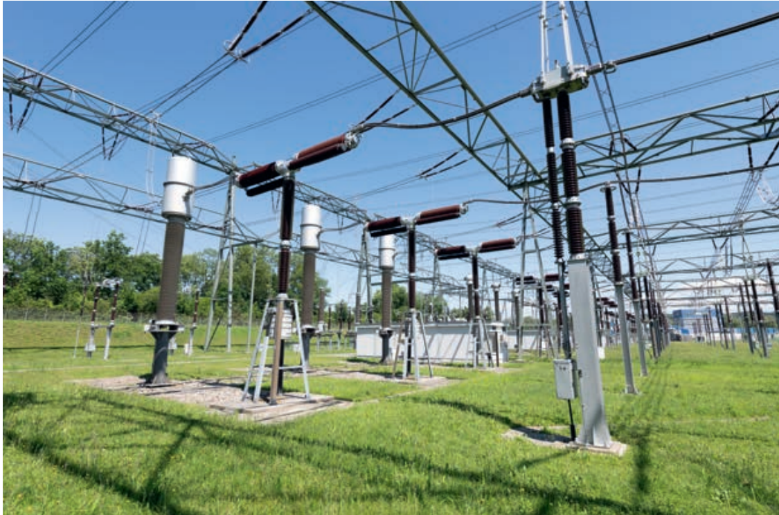
Unterwerk Gösigen der Swissgrid AG 380-kV-Hochspannungs- Schaltanlage
